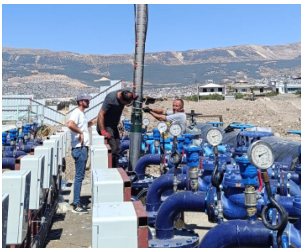
La distribuzione dell'acqua avviene tramite una condotta di 12 km.
