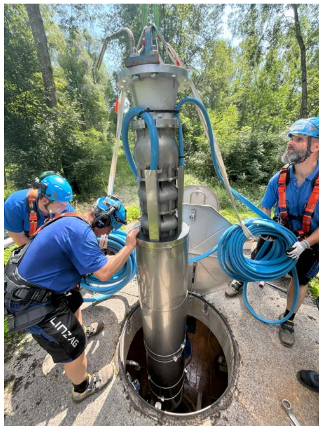
Installazione a una profondità di 30 metri in un pozzo per acqua potabile.
