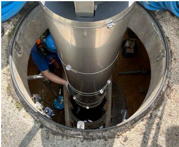
Das Aggregat ist 3 Meter lang und bringt mehr als 1000 kg auf die Waage.
