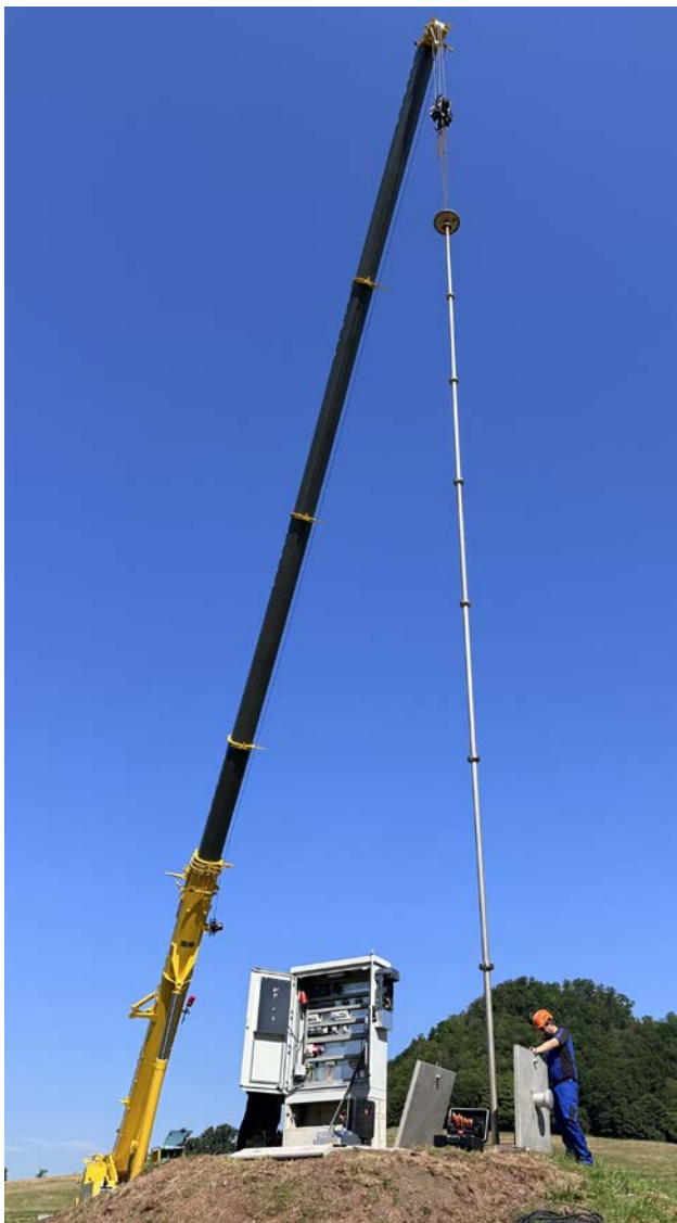
Das Pumpensystem befindet sich in einer Tiefe von 25 m.
