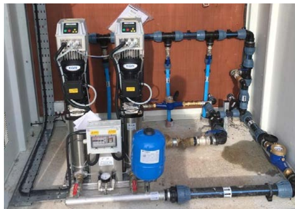
Die neue Druckerhöhungsanlage von Franklin Electric bietet ausreichend Druck und Durchfluss für die gestiegenen Anforderungen der Rennstrecke.
