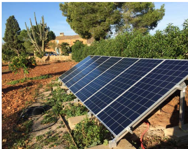
Ca. 2 kW Solarfeldleistung betreiben das HES und fördern genügend Wasser für die Plantage und das Landgasthaus.* (Solarleistung 2000 Wp STC)
