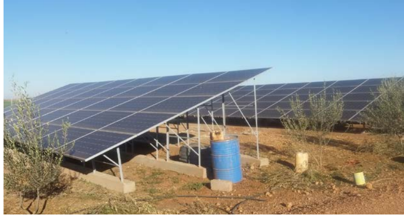
80 Solarpanele betreiben das Pumpensystem im 150 m tiefen Brunnen.
