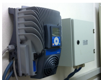
Frequenzumrichter und Filter montiert an der Wand
